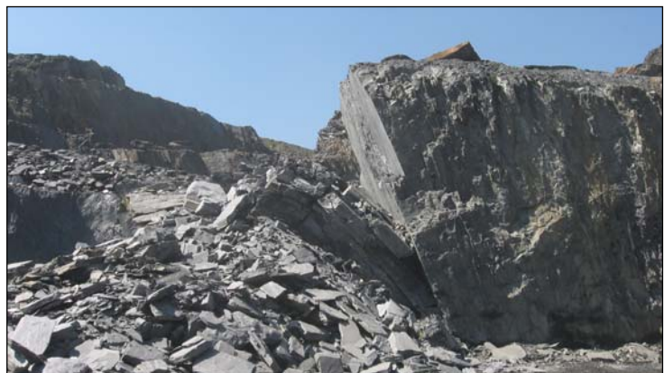
Fotografía 4.2.6.7.4.- Detalle de un talud invertido con desprendimientos por basculamiento. afa
