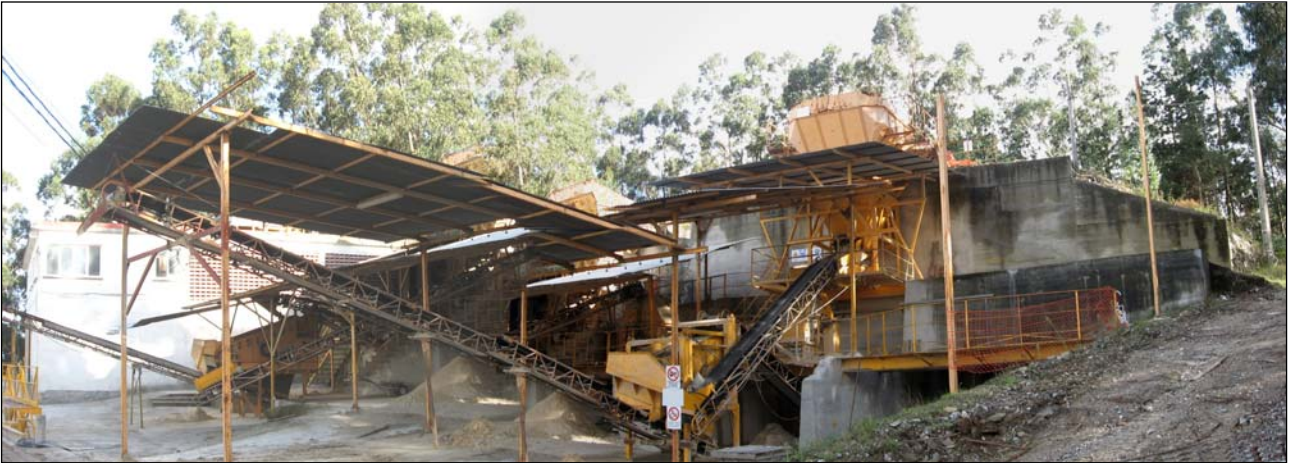
Fotografía 4.4.4.2.- Aspecto general de la planta de tratamiento de BASAZURI, S.L., con dos líneas de proceso. afa
